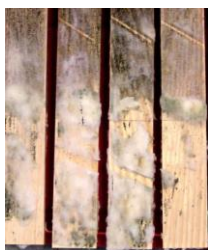
Photo 2: moisissures de surface
