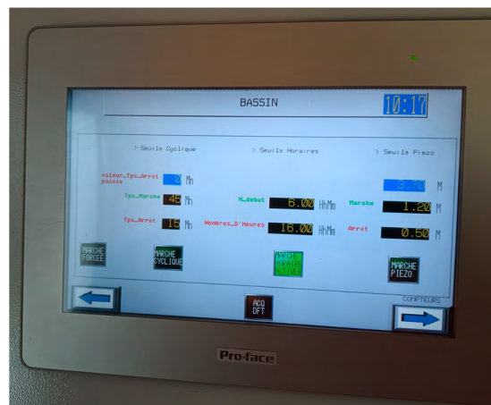
Exemple de tableau de commande d'une installation
